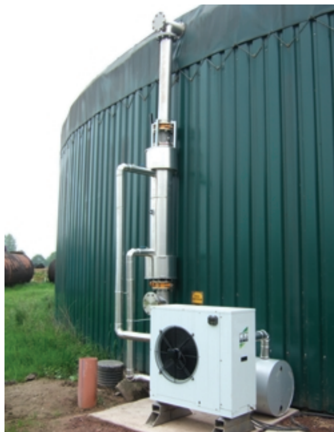
Abbildung 5: Gaskühlaggregat an einer 500 kW el -Anlage
